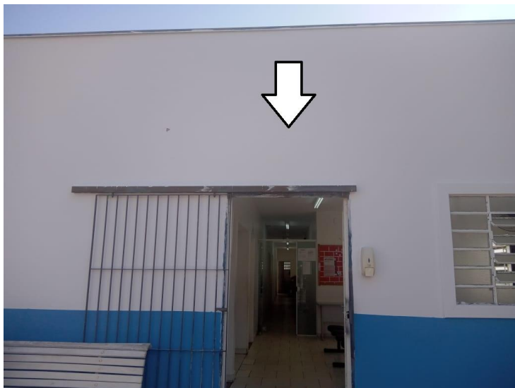
Foto 8 – Ilustração de local de instalação.
