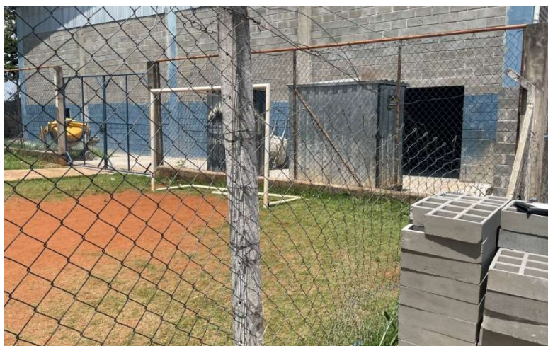
FOTO 1- Vista do trecho do alambrado que foi danificado
