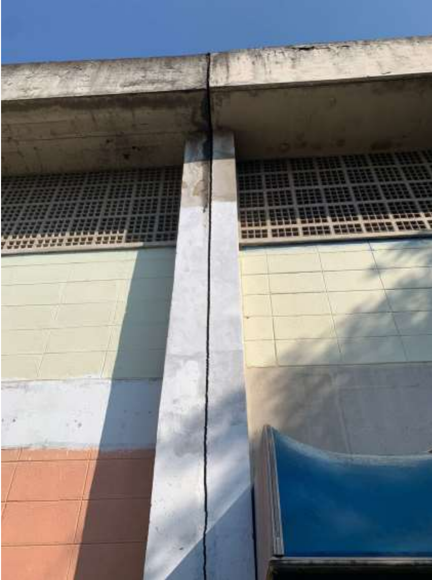
FOTO 6- Vista da Fissura na Frente do Bloco II
