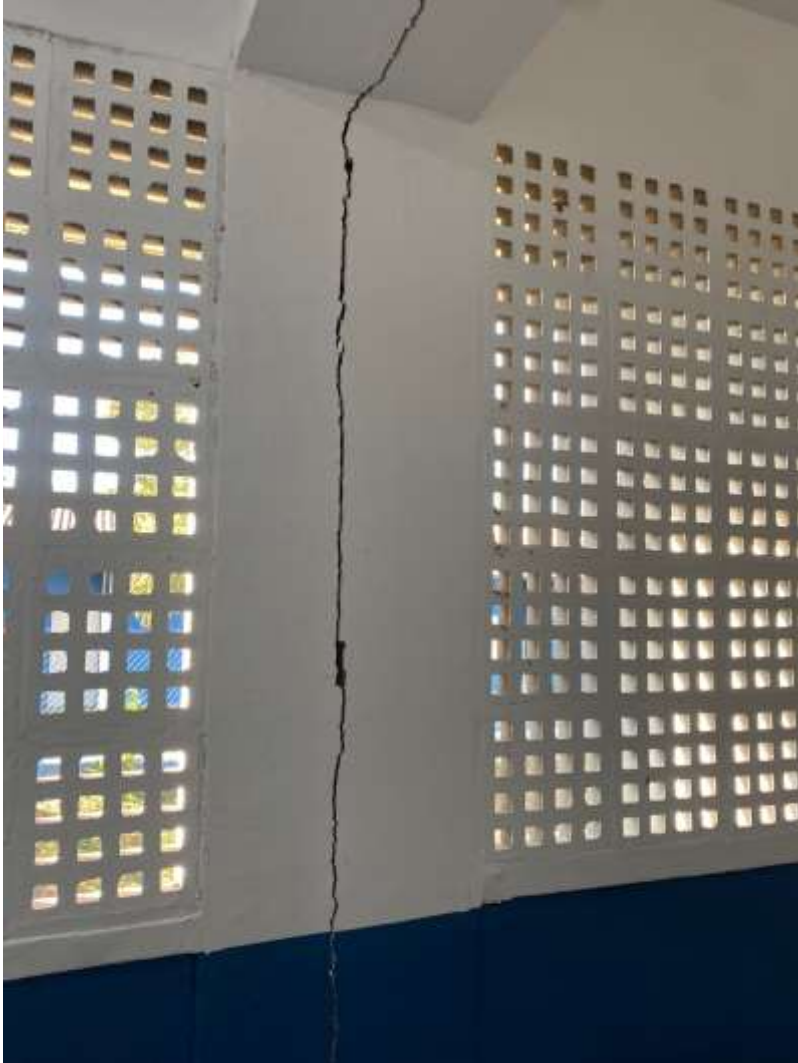
FOTO 1- Vista interna da Fissura
