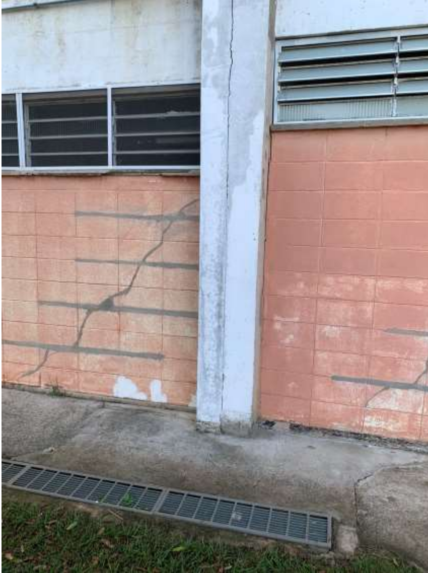
FOTO 5- Vista da fissura atrás do bloco II
