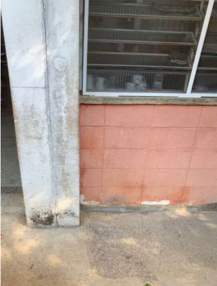
FOTO 4- Local da fissura
