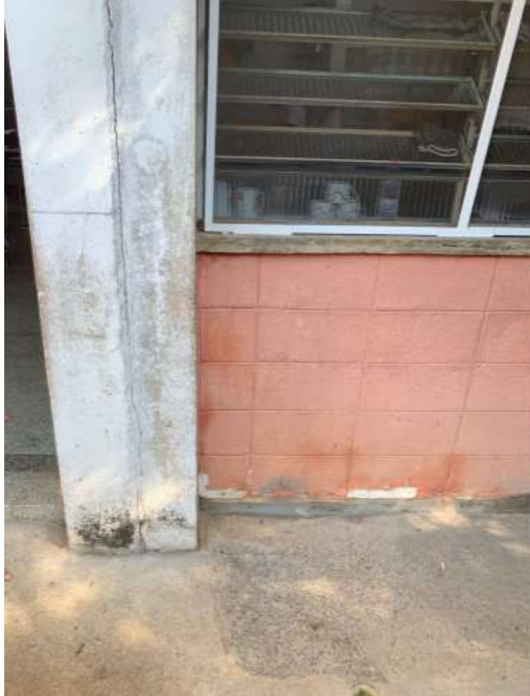
FOTO 4- Local da fissura
