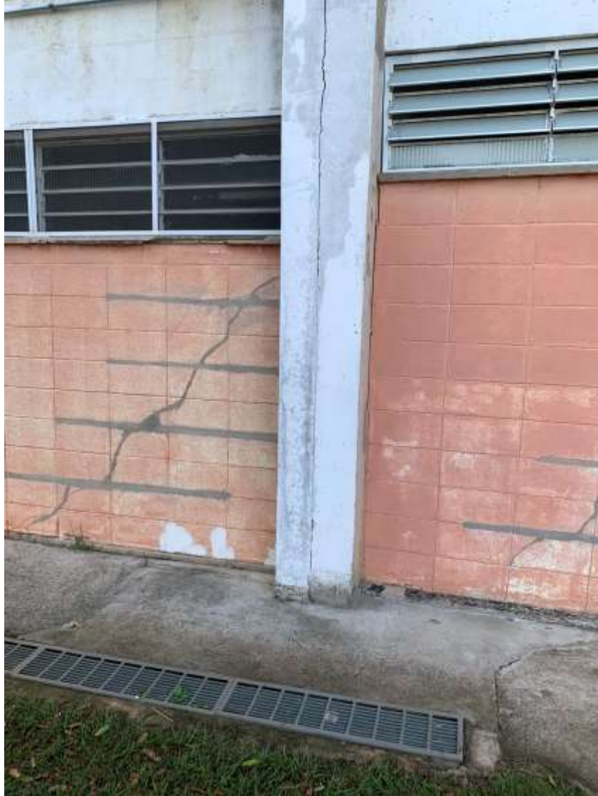
FOTO 5- Vista da fissura atrás do bloco II
