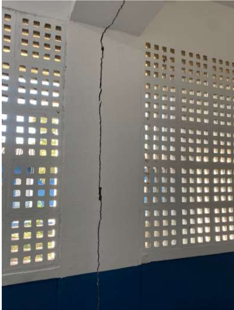
FOTO 1- Vista interna da Fissura
